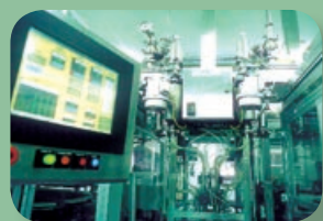
南京正大天晴非PVC大容量注射液生產車間
